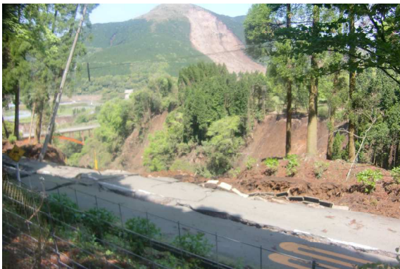
写真① (進入路斜面崩落の一部)
